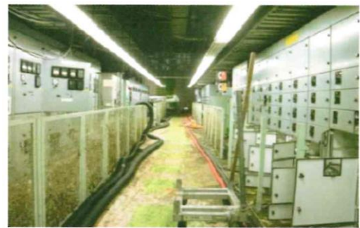
図 2-6 浸水した配電盤
