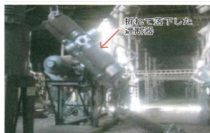
図 2-8 開閉所内で落下した遮断器
