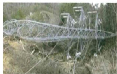
図2-7 倒壊した「夜の森線」の鉄塔
